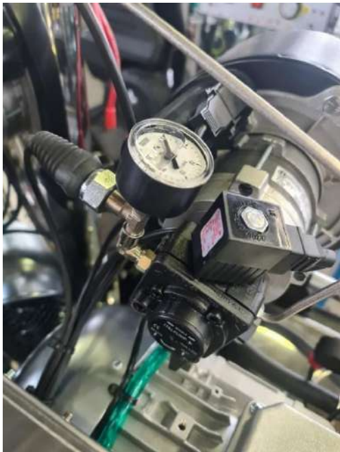
Manómetro de la bomba de gasóleo
