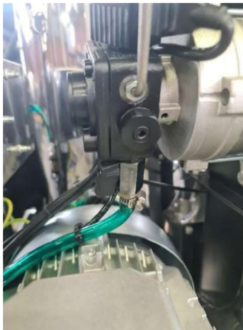
Válvula de bola de seccionamiento de gasóleo
