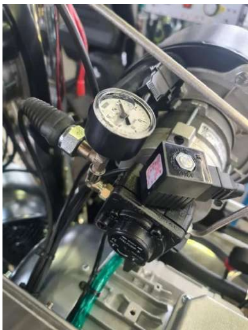
Manómetro de la bomba de gasóleo
