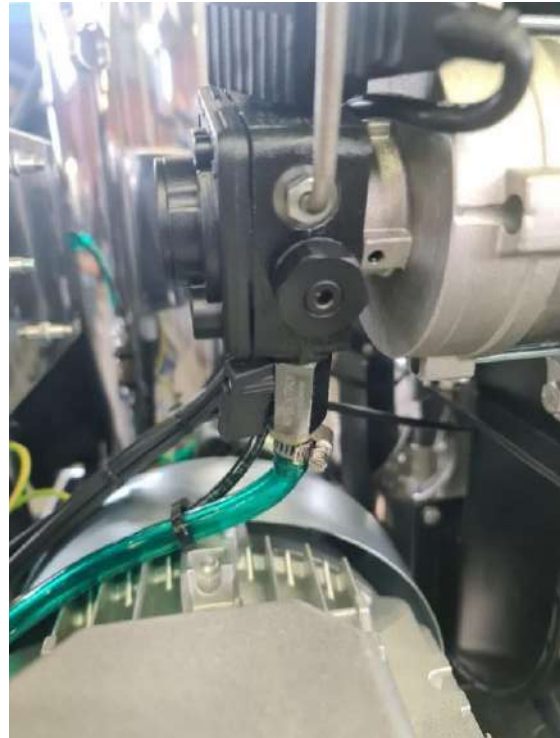
Válvula de bola de seccionamiento de gasóleo
