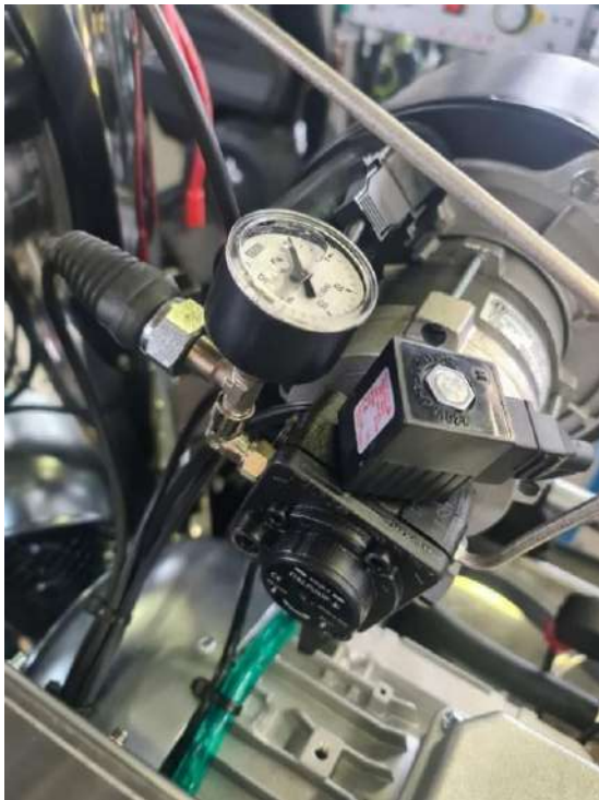
Manómetro de la bomba de gasóleo
