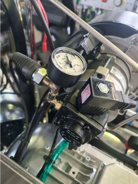
Manómetro de la bomba de gasóleo
