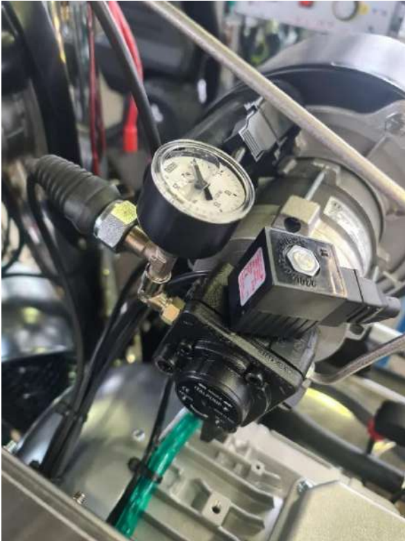
Manómetro de la bomba de gasóleo
