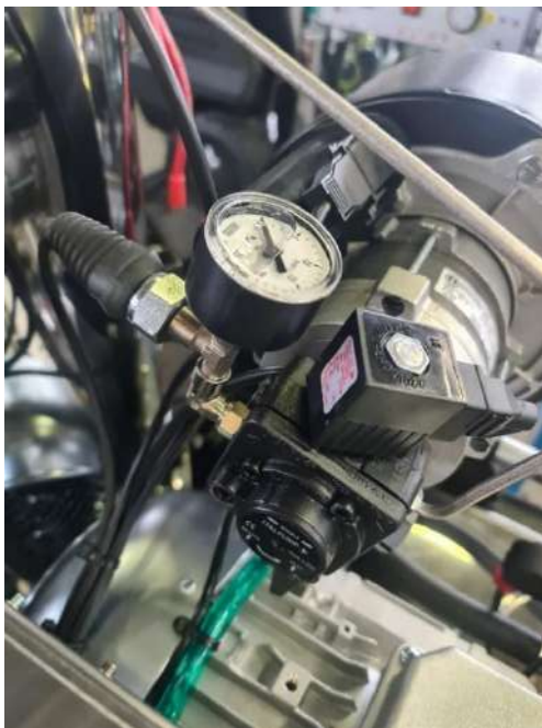
Manómetro de la bomba de gasóleo
