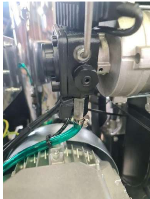
Válvula de bola de seccionamiento de gasóleo
