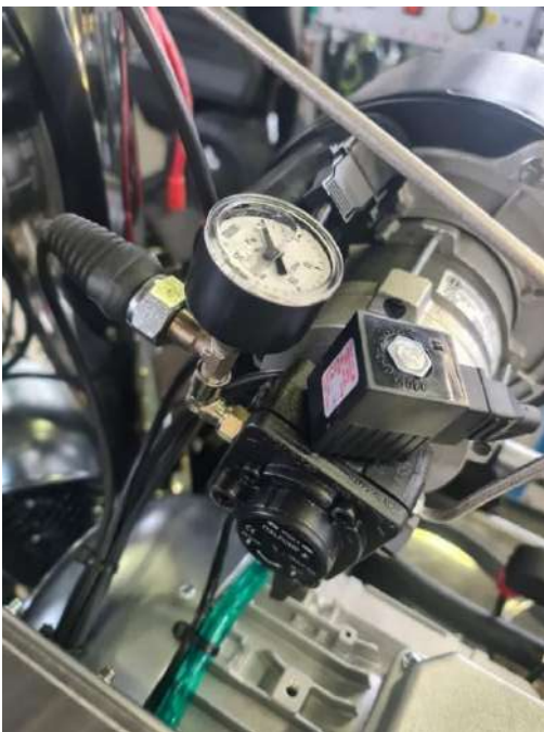
Manómetro de la bomba de gasóleo
